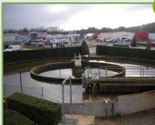
Station d'épuration de Giraud
